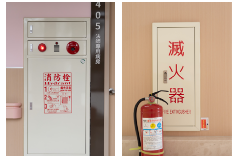
圖：消防栓、滅火器
