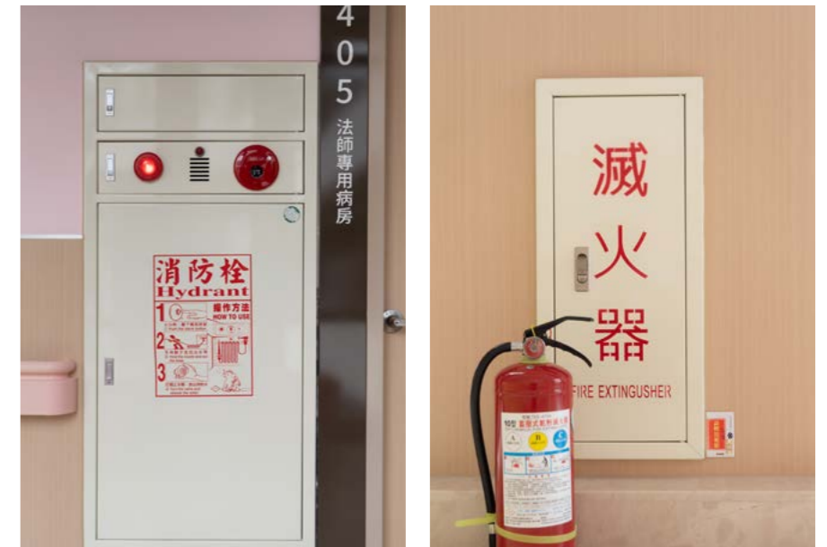
圖：消防栓、滅火器
